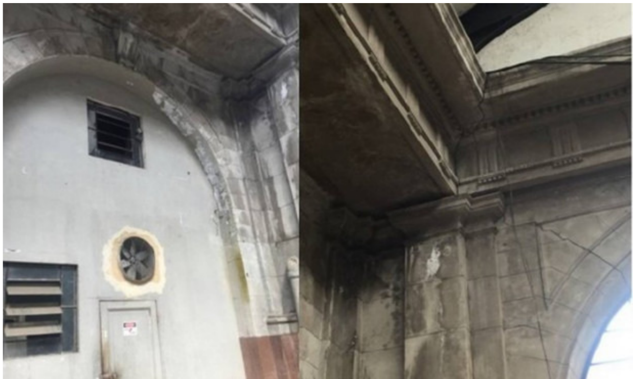
MPF flagrou rachaduras na parte externa e pequenos pedaços de reboco faltando
